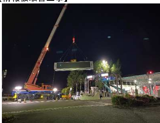
情報板の設置状況
