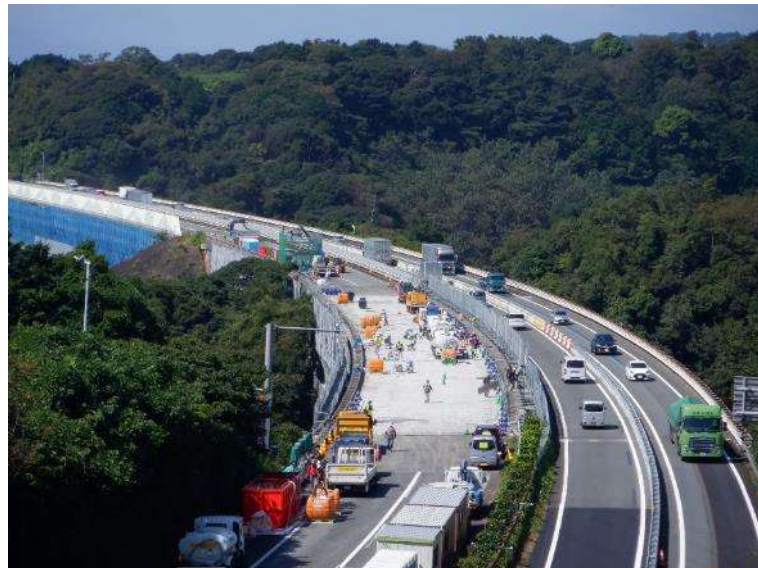
【コンクリート防護柵運用状況】
