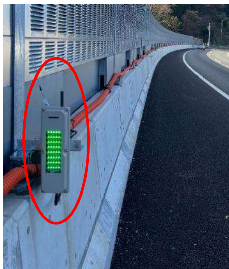
【路面点滅誘導灯の設置状況】
