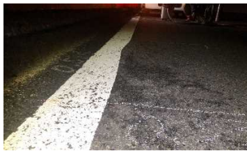
《舗装面の凹凸》
