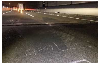
《舗装面の凹凸》
